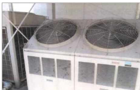
エアコン室外機
